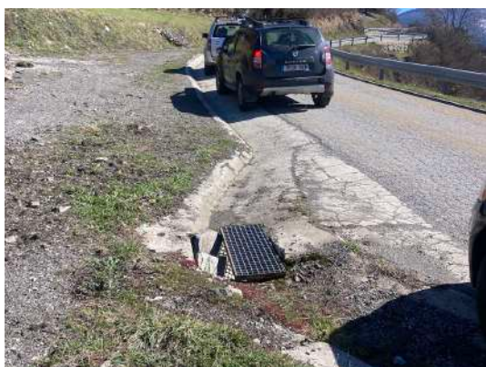
IMG 03. Embornal que condueix l'aigua pluvial a l'altra banda de la carretera
